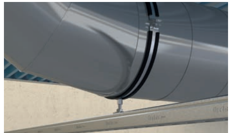
Ventilasjonskanaler og -rør
